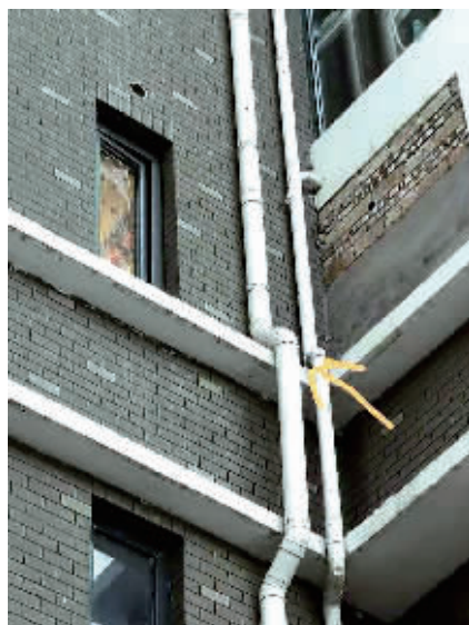
程先生家外墙排水管，箭头指示位置为断裂处。
