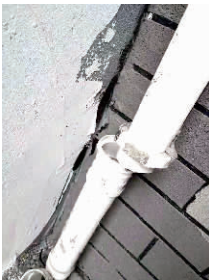
7号楼外墙水管断裂
